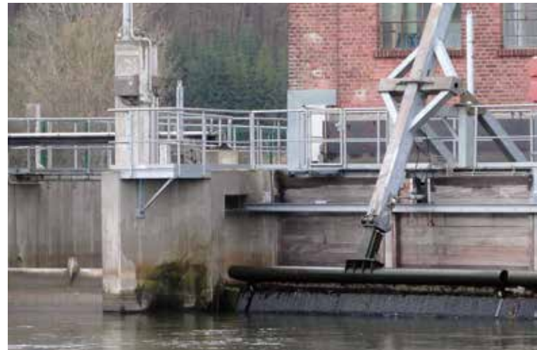
Rechen zur Reinigung einer Wasserkraftanlage (© Gerhard Kemmler)
