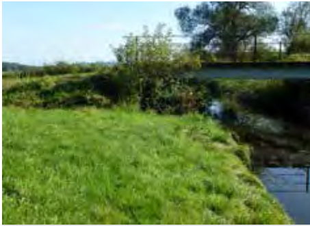
Das Niveau der Brücke zeigt das Ausmaß einer Moorsackung durch Entwässerung in den vergangenen 100 Jahren. Der Niveauverlust beträgt etwa einen Meter.
