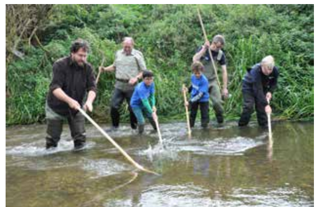
Nachdem der Kies mit Baggern eingebracht wurde, geht es an die Verteilung in handarbeit. (© M. Weichenhan / LAV Brandenburg e.V.)
